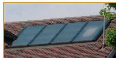
◀ L'installation solaires thermiques
