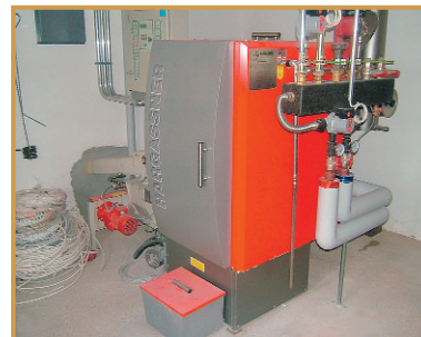
◀ La chaufferie à copeaux de bois de 55 kW
