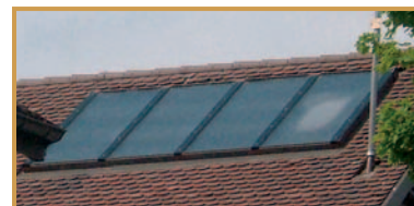
◀ L'installation solaires thermiques
